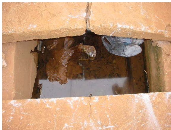
Figura 2.- Roturas y tupidaciones en el alcantarillado pluvial en el asentamiento Alquizar
